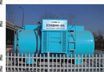
杭州闲林街道MBR一体机污水处理工程
